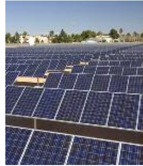
Solar PV array, Las Vegas
